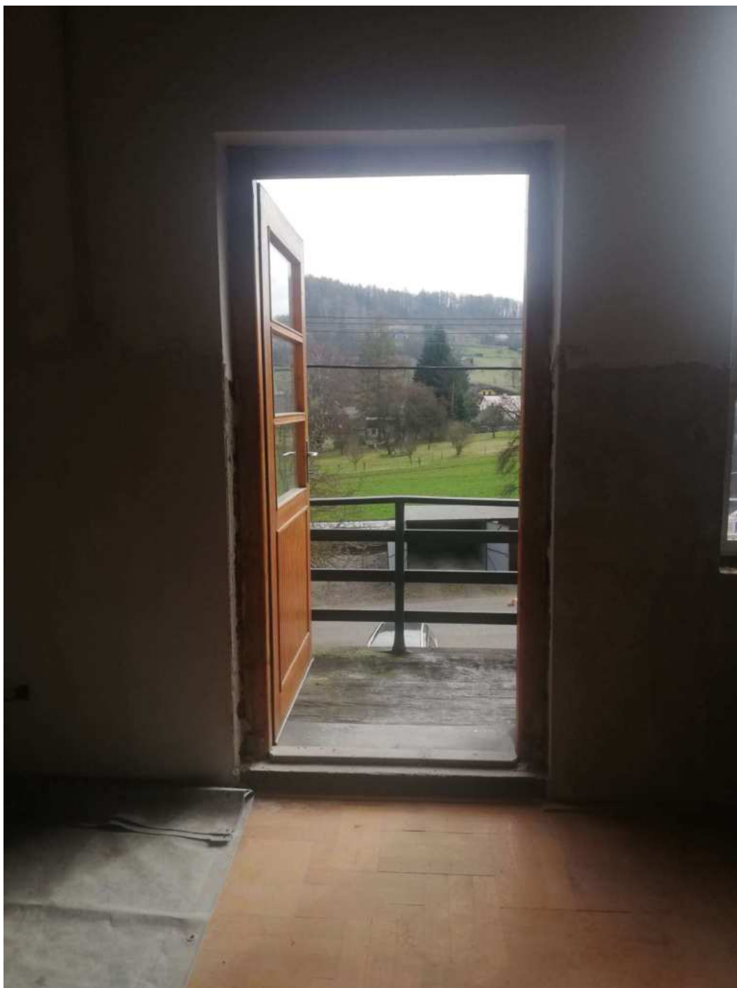
Detail balkonových dveří (součástí výměny těchto balkonových dveří je vybourání zvýšeného prahu – u nových balkonových dveří bude práh minimální)
